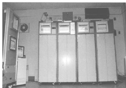
測定局舎内部の自動測定機
