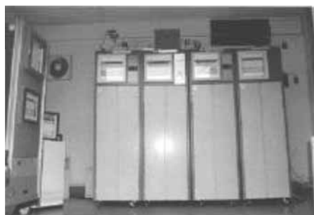
測定局舎内部の自動測定機
