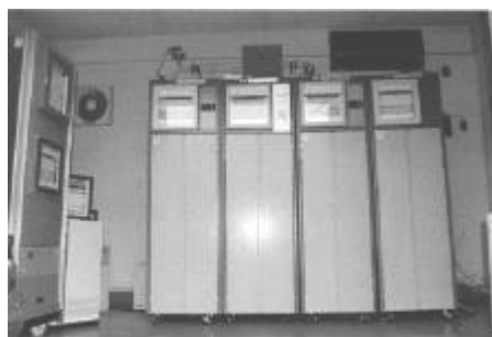
測定局舎内部の自動測定機
