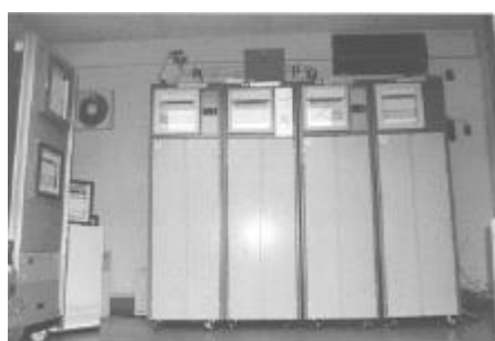
測定局舎内部の自動測定機
